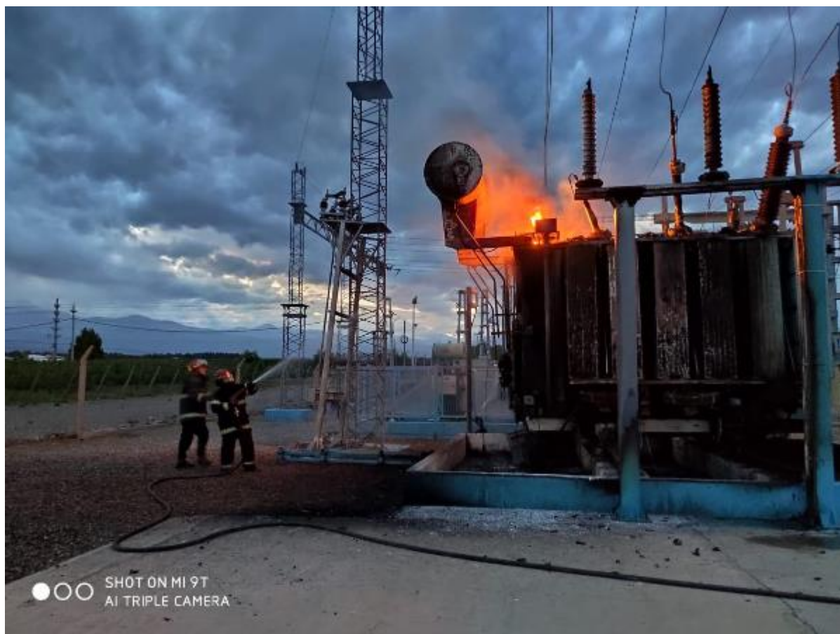
Bomberos trabajando en el incendio – foto cortesía Prensa Municipalidad de Tupungato
